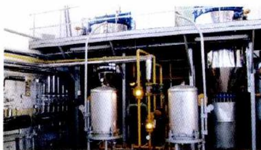
Установка на химическом предприятии
